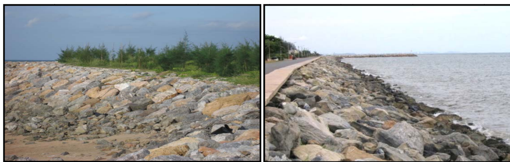
กำแพงป้องกันคลื่นรุมชายหาดโดย (ซ้าย) การปูหรือเรียงก้อนหินบนหน้าหาดโดยตรงบริเวณพระราชินีวนัตถุทายวัน อำเภอชะอำ จังหวัดเพชรบุรี และ (ขวา) การปูหรือเรียงก้อนหินซ้อนทับไว้หน้า กำแพงป้องกันคลื่นรุมชายฝั่งบริเวณหาดทรายทอง อำเภอมายาตพุด จังหวัดระยอง
