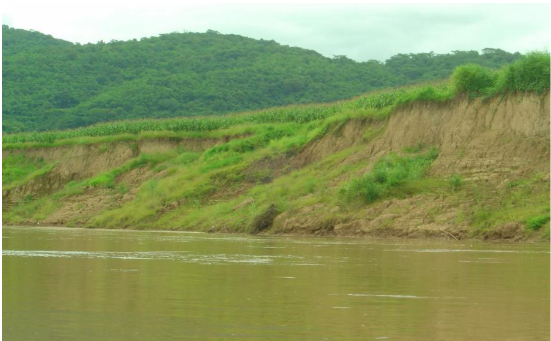
รูปที่ 3 แสดงภาพถ่ายตลิ่งแม่น้ำโขงบริเวณตำบลบ้านแซวที่โดนกัดเซาะ
