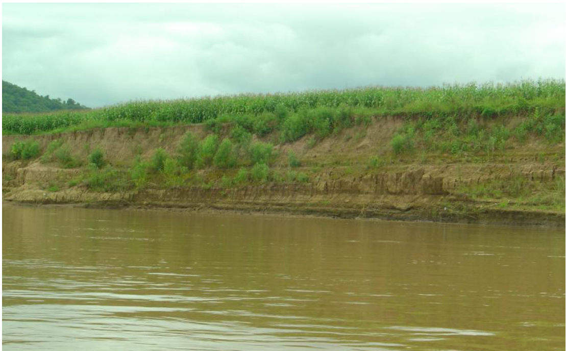
รูปที่ 4 แสดงภาพถ่ายการพังทลายบริเวณตลิ่งแม่น้ำโขงบริเวณตำบลบ้านแซว จังหวัดเชียงราย
