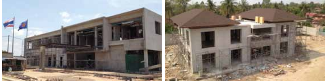
โครงการก่อสร้างอาคารที่ทำการและบ้านพักกงสุลใหญ่ ณ แขวงสะหวันนะเขต เริ่มก่อสร้างเมื่อวันที่ ๑ มีนาคม ๒๕๕๕ คาดว่าจะแล้วเสร็จเดือนกุมภาพันธ์ ๒๕๕๗
