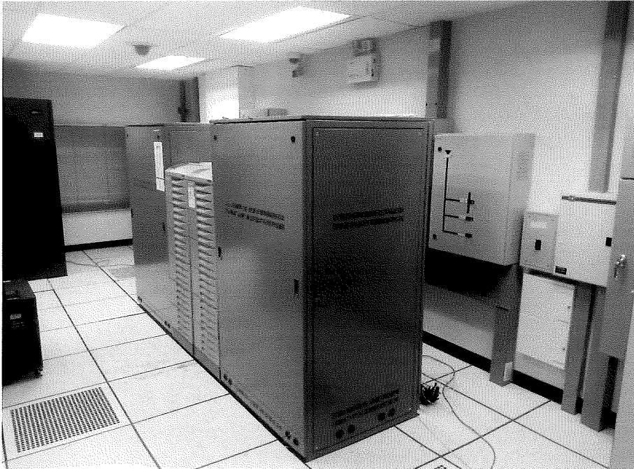
รูปที่ ๒ UPS ขนาด ๖๐kVA เดิมที่จะต้องขนย้ายออกจากพื้นที่
