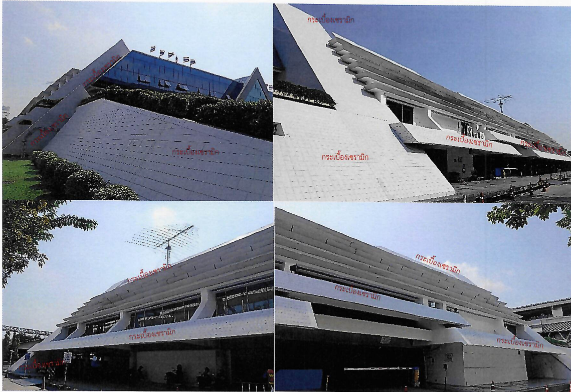
- งานขัดล้างกระเบื้องเซรามิก ด้านหน้าและด้านข้างอาคารทั้งหมด
