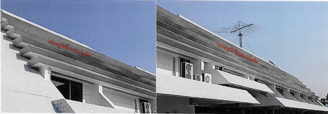
- งานขัดล้างแผ่นอลูมิเนียมคอมโพสิต ข้างอาคารทั้งหมด
